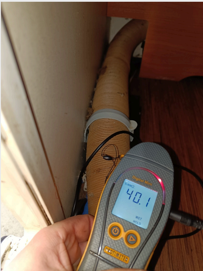
1.12 40,1% i gulv inntil veggen forran lasteluke vestre side. Bør utbedres.
