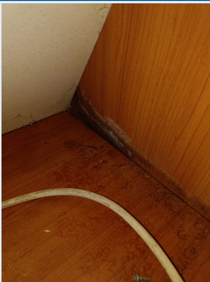
1.12 76,1% i frontvegg på bad nede ved blomsterbrettet. Her er det også mugg/sopp på sideveggen
