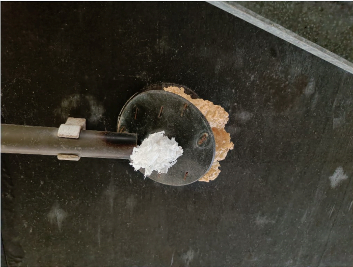
2.13 Gulv under bad har 3 hull rett inn. Ser ut som det er gjort med hullsag. Her MÅ det utbedres.
