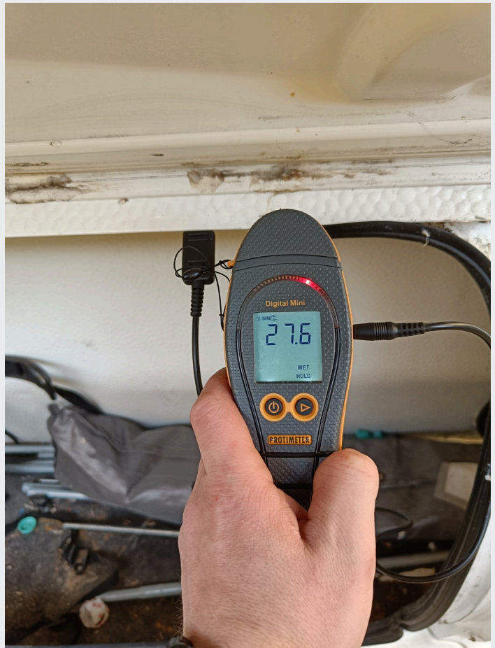
2.11 Fukt venstre side fremme. 27,6%
