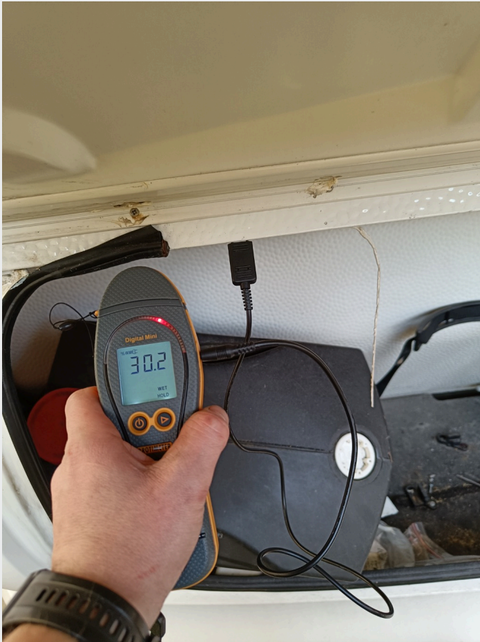
2.11 Fukt i høyre hjørnet fremme. 30,2%
